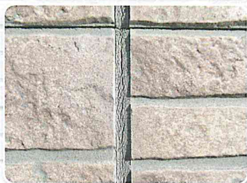
シーリングの劣化
